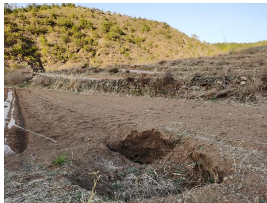
照片 4-2 地面塌陷坑
