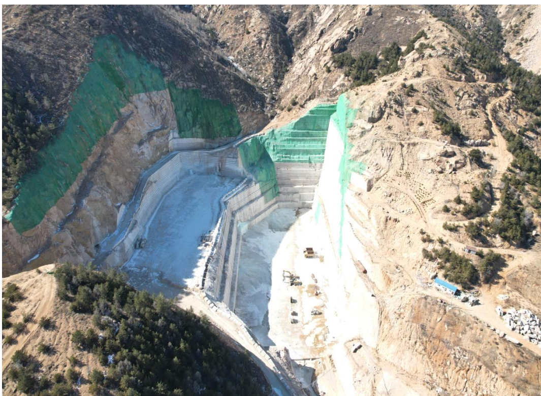
照片 1-1 露天采坑
